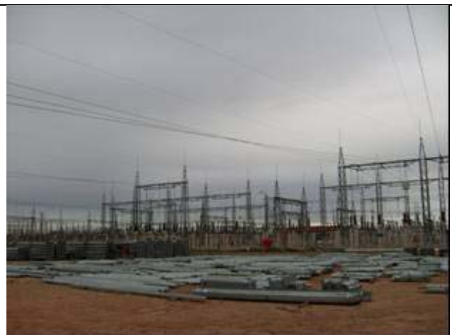
Foto 2.6-6 - Subestação Campos - Campos dos Goytacazes - RJ
