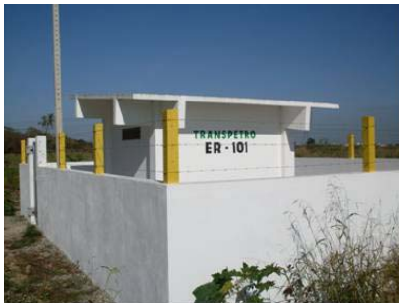
Foto 2.5.1-18 – Estação Reguladora de pressão do Gasoduto Cabiúnas – Vitória de propriedade da Petrobras (proximidades do vértice V32).
