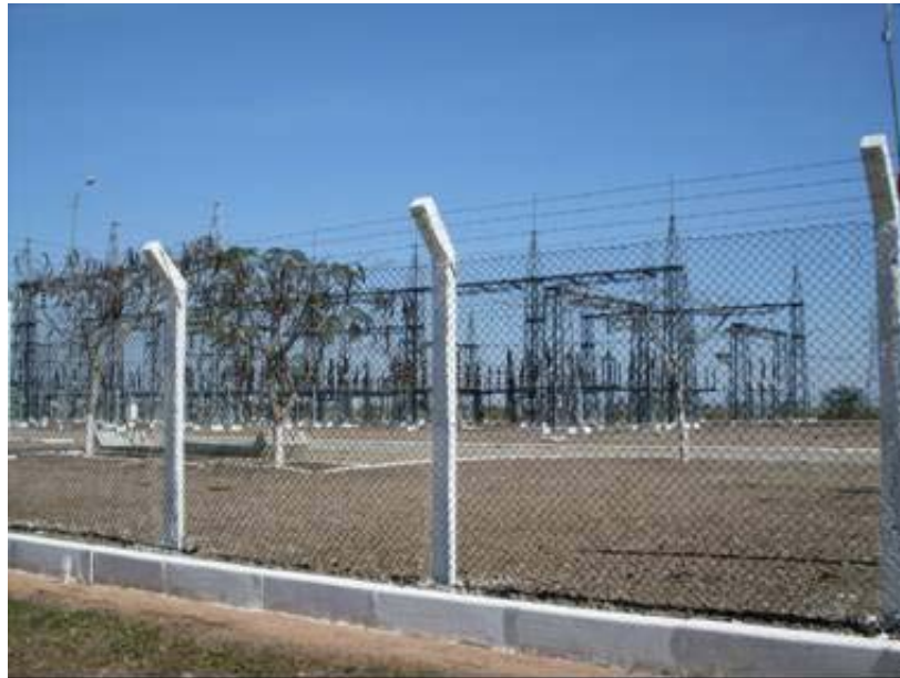
Foto 2.5.1-19 – Subestação Mombaça – Ampla Energia e Serviços S.A. nas margens da Rodovia RJ – 158 (proximidades do vértice V32).
