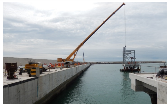
Berço de atracação do TGNL.
